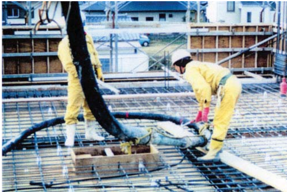
コンクリートとあつそうさぎょう ようす おペレーたいちめい つつさきさぎょういんいちめい コンクリート圧送作業の様子(オペレータ1名、筒先作業員1名)
