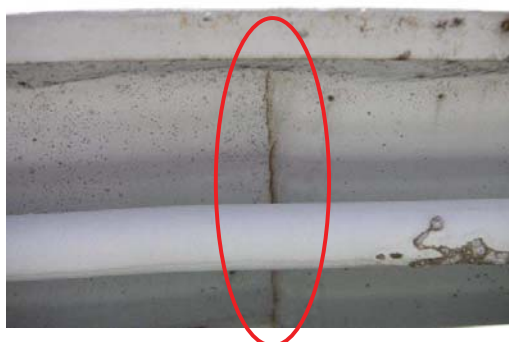
ブームに発生した 亀裂(クラック)の例
