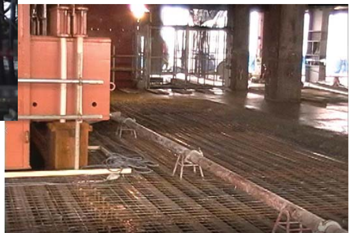
上部水平配管の例
