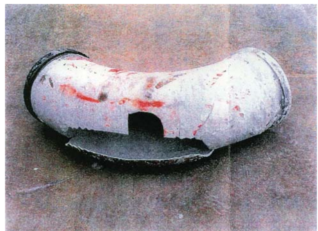
破裂したベント管の例
